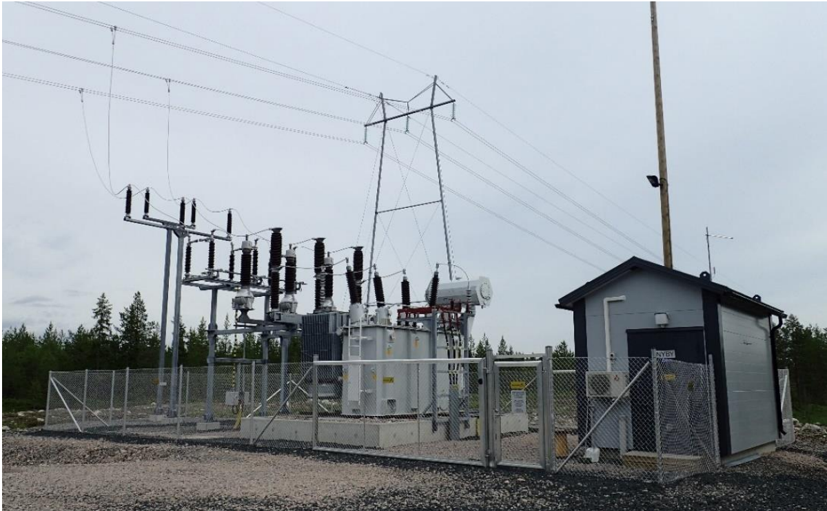
Kuva 2.12 Esimerkki tuulivoimapuiston sähköasemasta.
