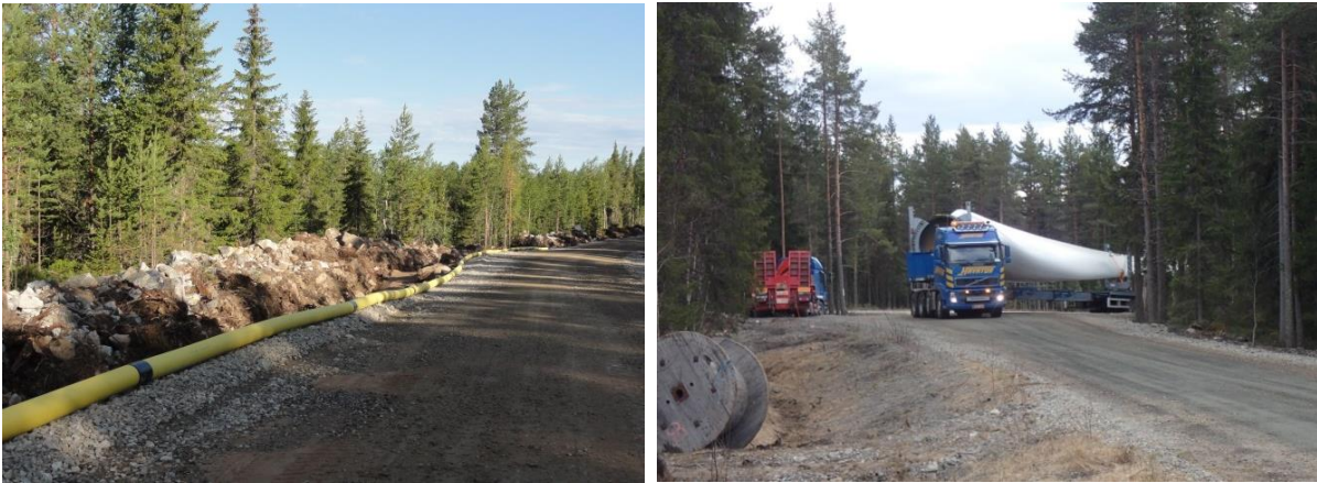
Kuvapari 2.11 (Vasemalla) Esimerkki tuulivoimapuiston rakennus- ja huoltotiestä rakentamiskäytännössä. (Oikealla) Tuulivoimalan osia kuljetetaan erikoiskuljetuksina. (Kuvat: Ville Suorsa, FCG)
